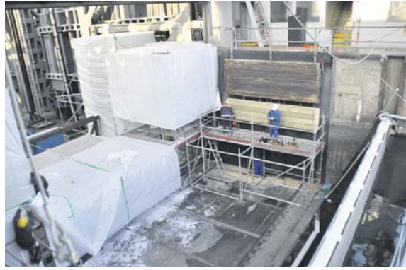
Wartungsarbeiten am Fuße des Schiffshebewerkes Niederfinow. Die Erneuerung von Holzbohlen zählt in diesem Jahr zu den Hauptaufgaben.
